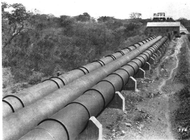
FIG. 11. — Conduites forcées. Tronçons à faible inclinaison. Vue prise d'aval vers l'amont.
