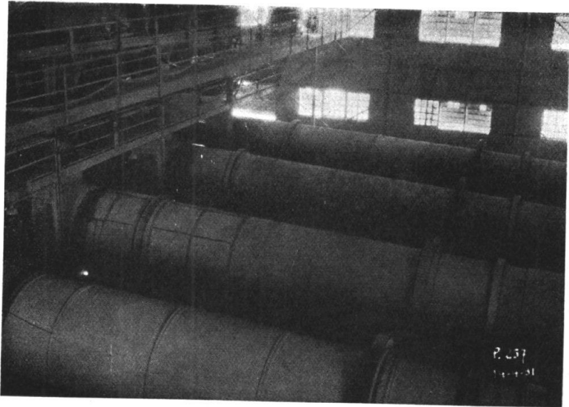
PHOTO 4. — Hall des sécheurs des minerais broyés.
